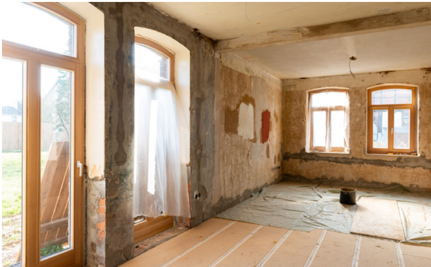
Fachwerkhaus vor der Sanierung. Foto: conluto
